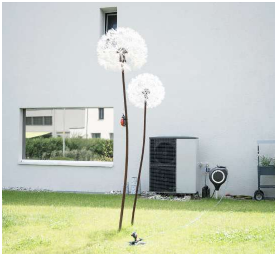
Steht eine Luft-Wasser-Wärmepumpe ausserhalb des Hauses, braucht es einen Schallschutznachweis. In einigen Fällen ist zudem eine Baubewilligung nötig.
